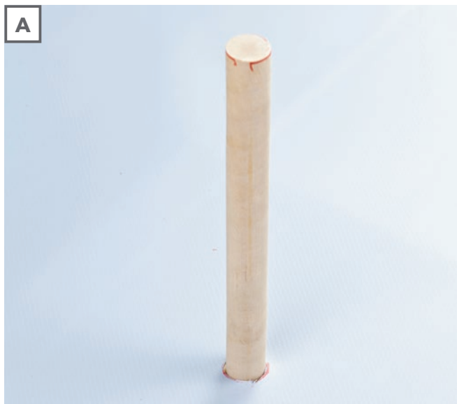
А. Для герметизации проходов малого диаметра в кровле (громоотводы, кабели, стойки крепления и др.) вырезается из неармированной мембраны круг радиусом около 150 мм.
